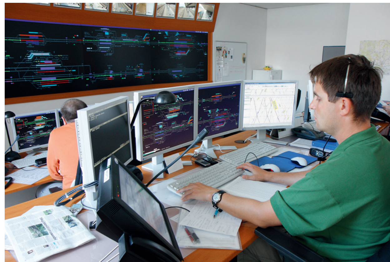
Pracoviště centrálního dispečerského pracoviště (CDP) Přerov, foto: SŽDC
